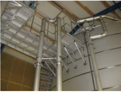
Bild 3: Neuer Trinkwasserspeicher am Wasserwerk Föhr-West (Edelstahltanks 2 \times 400 \text{ m}^3 )
