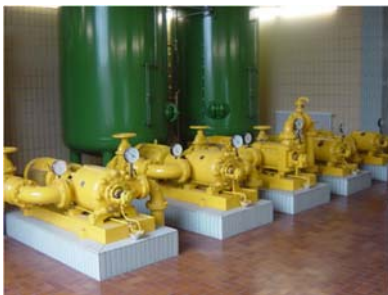
Bild 3: Alte Netzpumpen Wasserwerk Föhr-Ost
