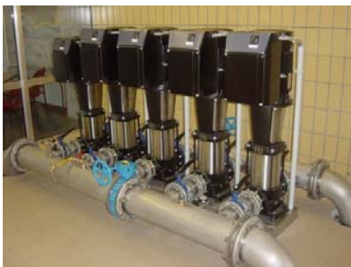
Bild 1: Neue Netzpumpen Wasserwerk Föhr-Ost
