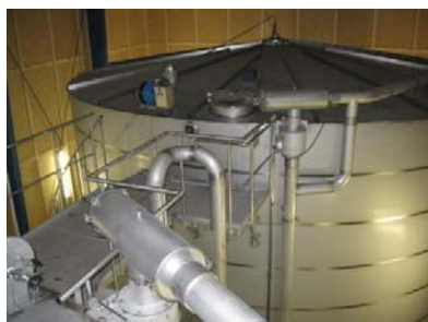
Bild 2: Neuer Trinkwasserspeicher am Wasserwerk Föhr-West (2 x 400 m 3 Edelstahl tanks)
